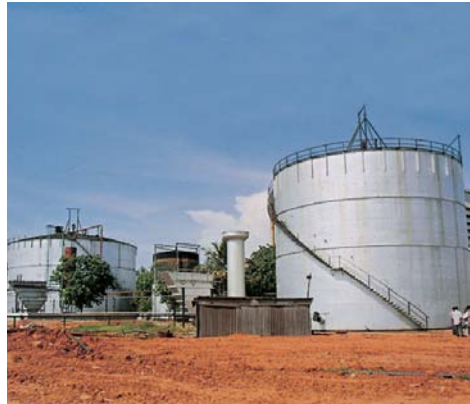
Biogasanlage in Indien mit grossen Behältern der Entschwefelungsanlage
