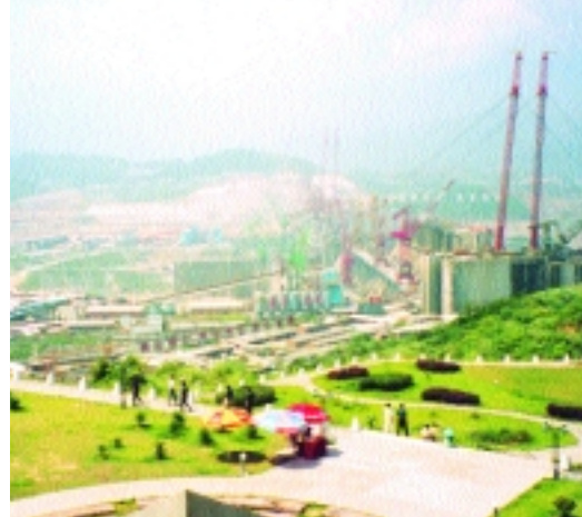
Der Bau des gigantischen Drei-Schluchten-Staudamms in China wird 2 Millionen Menschen zur Umsiedlung zwingen und 13 Grossstädte und 140 Kleinstädte überschwemmen.
